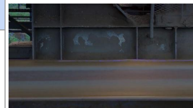
ベルトコンベアの事例（青→赤が劣化の度合い）
